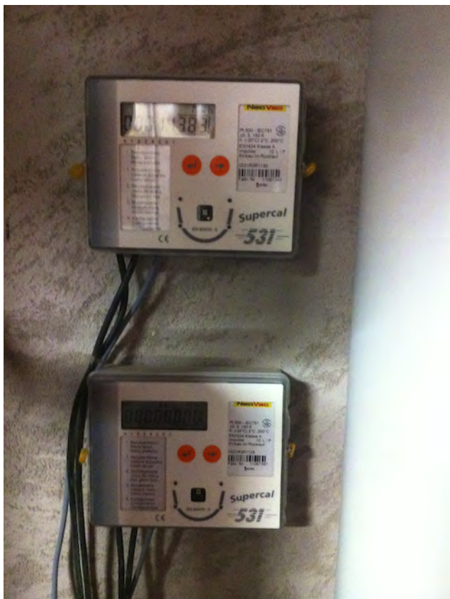
Heizungskeller (Wand) - Heizung HK 3 / HK 4
